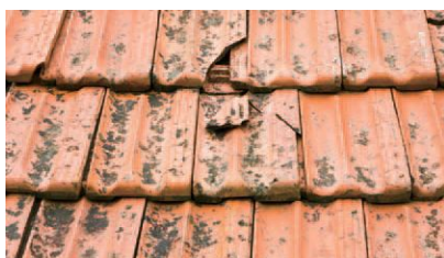
ひび割れ 屋根材が割れたり、欠ける
